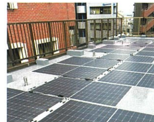
▲ご自宅の屋上に設置
